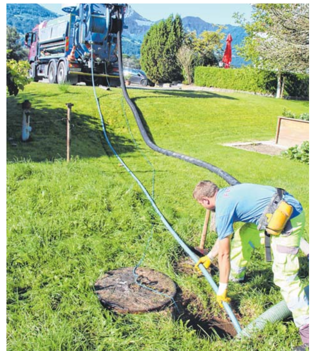
Die Beschaffenheit aller Schächte und Kanäle in Satteins wird derzeit erhoben und diese werden auf Schäden geprüft.
